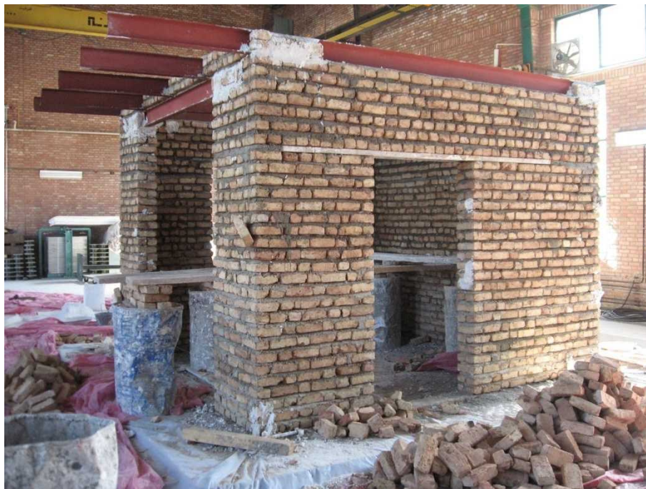
اتصال نامناسب بین دیوار و سقف
